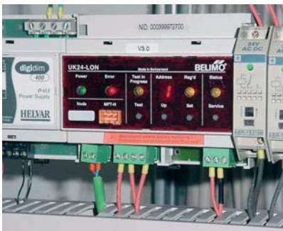
Blick in einen dezentralen Schaltschrank, in welchem sich die UK24LON-Gateways und die TAC-Xenta-Regler befinden.
