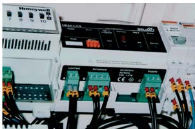
MP/LONWORKS-Gateway UK24LON im Schaltschrank; zusammen mit dem Excel 500-System.
