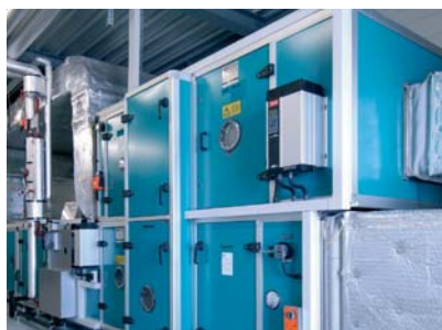
Blick in eine der HLK-Dachzentralen.
