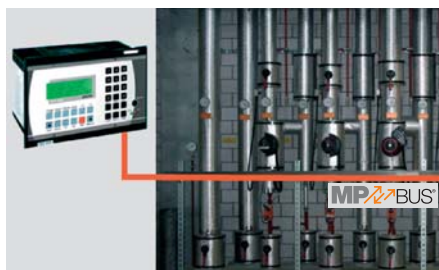
Heizungszentrale: Die Heizgruppen (Ventile und Sensoren) sind via MP-Bus an die Unterstationen von Kieback & Peter angebunden.
