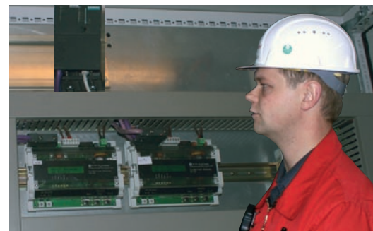
Helmut Blekker, chef de chantier d'ExxonMobil, devant l'armoire de commande dotée de la station d'automatisation des processus (en haut), ainsi que des passerelles Profibus/MP-Bus (en bas).
